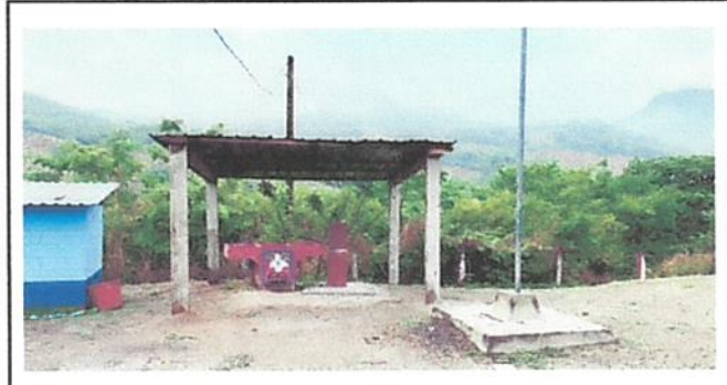
Foto 3: Torta de cemento deteriorada donde se encuentra la pila
