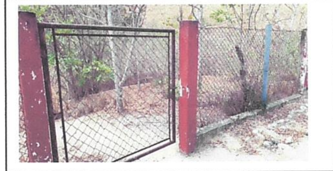
Foto 6: El porton de ingreso se encuentra en mal estado
